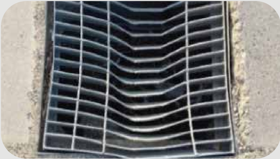
일반 격자형태 그레이팅 파손 피해
